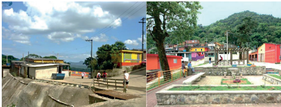
Figura 3 – Bairro Cota 200 – Obra de contenção de taludes (lado esquerdo) e Implantação de uma praça (lado direito).
