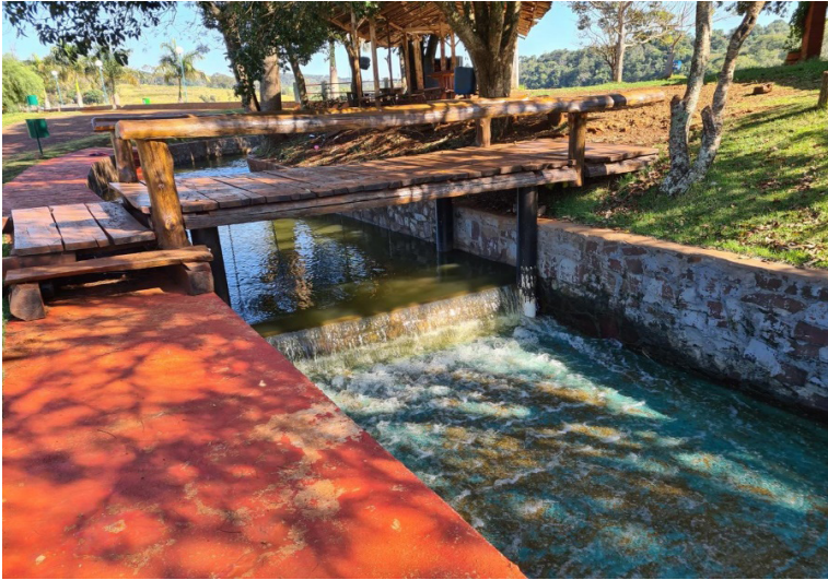
Figura 1: vertedor sem contração instalado em um canal retangular, com função paisagística.
