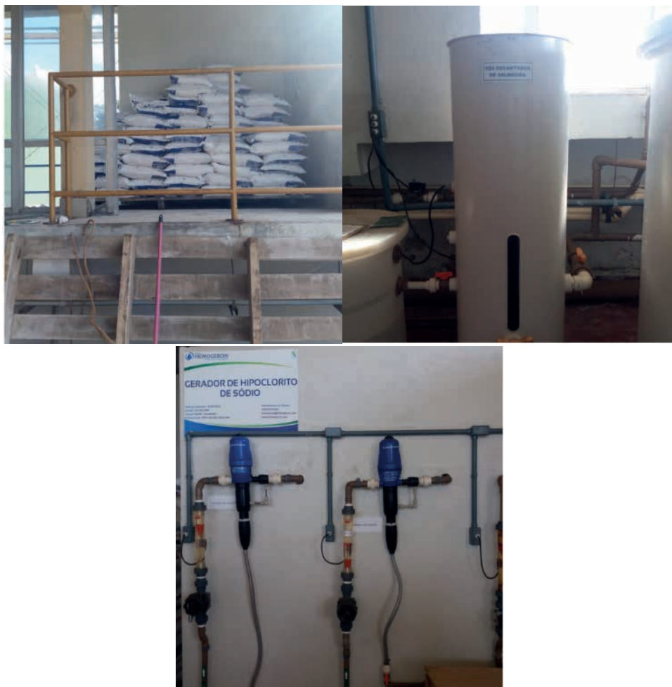
Figura 7: Sistema de purificação do hipoclorito de sódio
