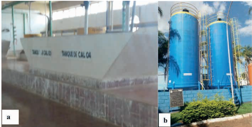
Figura 2: (a) tanque manual para adição de cal virgem em pó; (b) armazenamento de cal hidratada Fonte: Acervo do Autor (2023).
