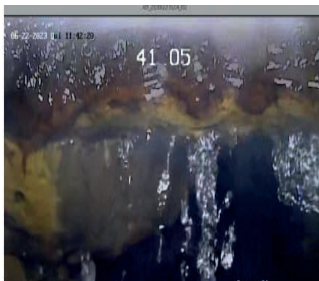
Figura 8: mostra presença de matéria orgânica na área onde deveria haver a cimentação. Notar as porções amareladas.
