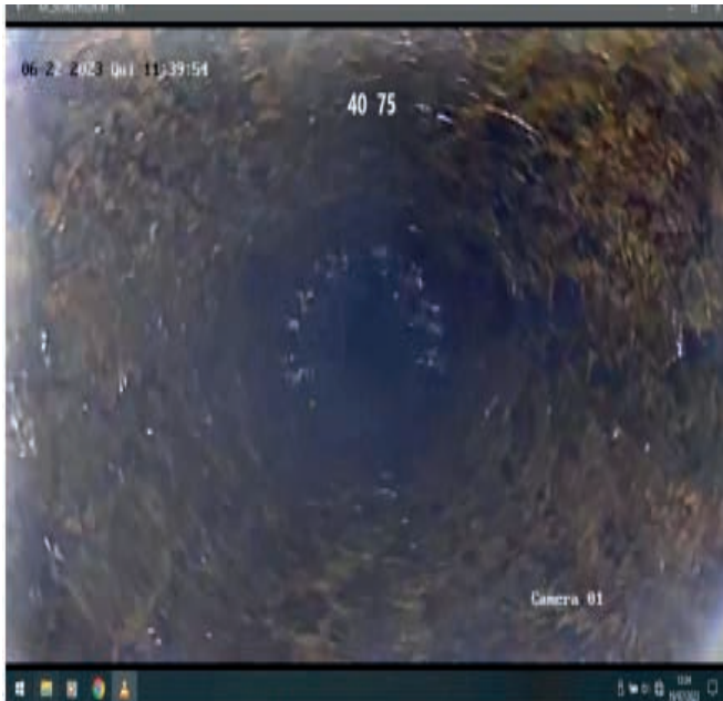
Figura 6: mostra revestimento comprometido e saída de agua abaixo dos 40,75 metros de profundidade
