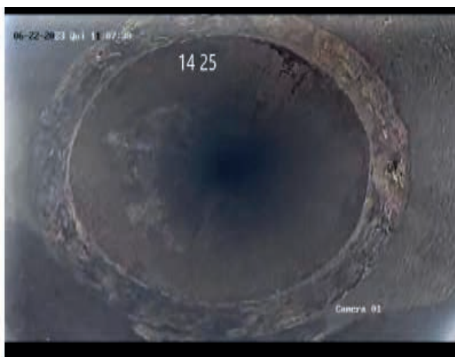
Figura 4: mostra solda no revestimento em decomposição aos 14,25 metros de profundidade.
