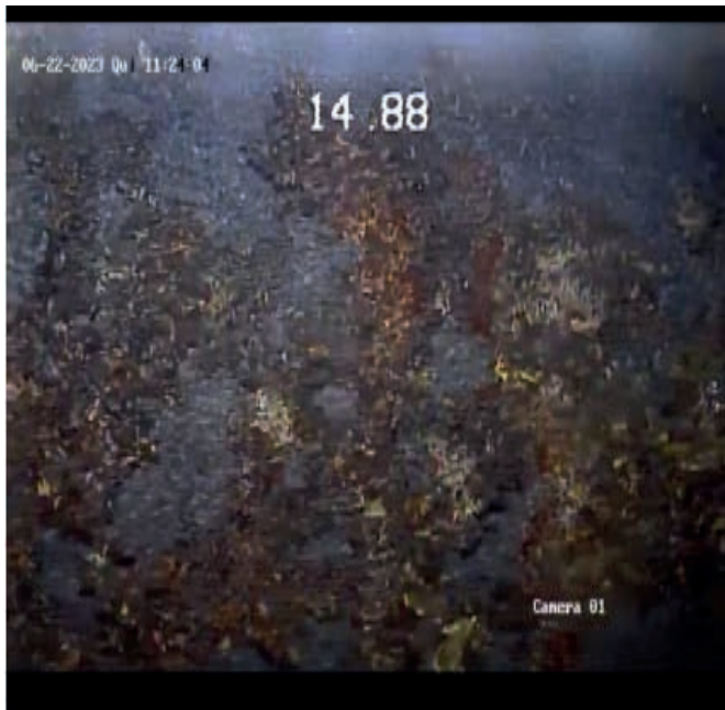
Figura 5: mostra paredes oxidadas, observar os pontos amarelos e vermelhos , aos 14,88 metros de profundidade.
