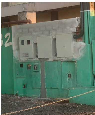
Figura 2 – Entrada de Energia
