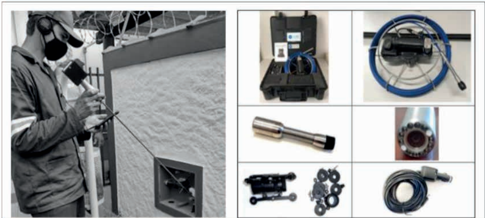
Fig 4 – Pesquisa de vazamentos não visíveis – Sistema automatizado
