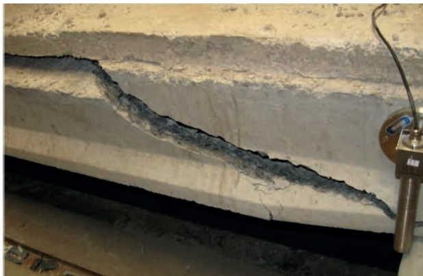
Figura 4 – Ruptura por tração diagonal de uma laje alveolar, Santos (2014).
