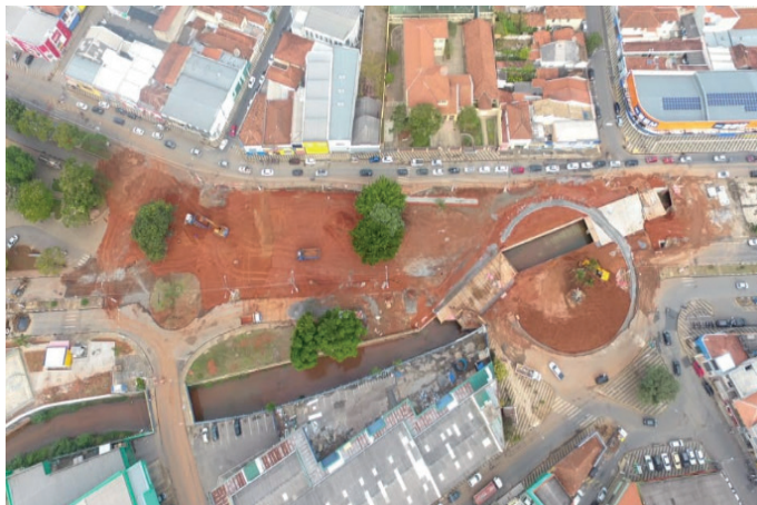
Figura 13: Remodelamento de trecho do canal do ribeirão Lavapés, Praça Chico Major (Jornal mais Bragança - 05/06/2020).
