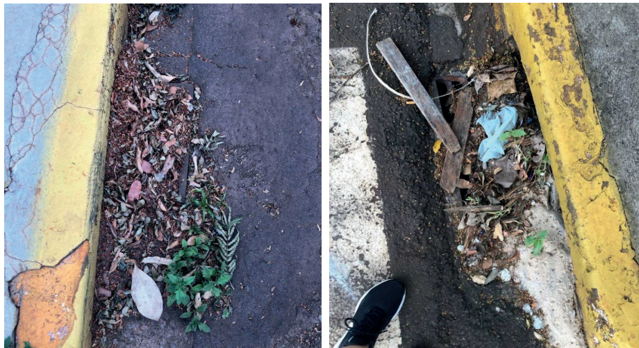
Figura 8 – (a) e (b) Resíduos Sólidos nas bocas de lobo
