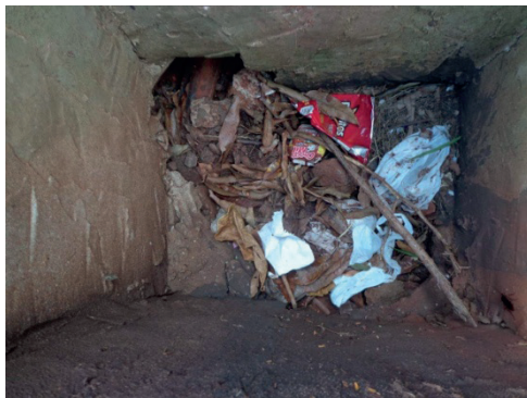
Figura 7 - Resíduos sólidos encontrados antes da instalação do cesto coletor dentro da rede de drenagem
