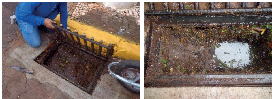
Figura 10: Manutenção do Bueiro inteligente
