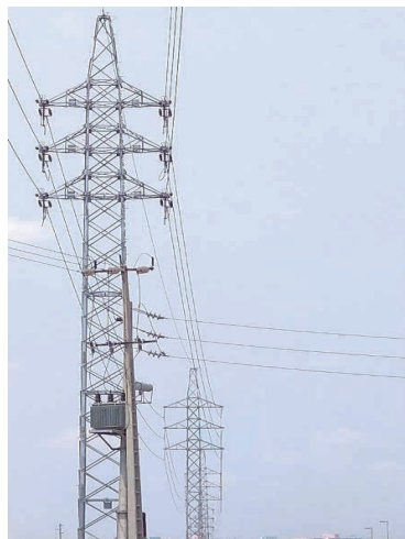
Figura 7. Cruzamento de LT 60 kV e 30 kV
