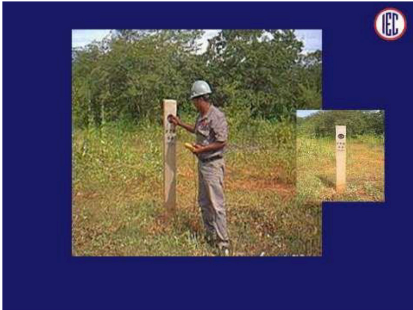
Figura 11: Medição do potencial de proteção catódica no Ponto de Teste de uma adutora enterrada. O Ponto de Teste possui um fio elétrico ligado à adutora.
