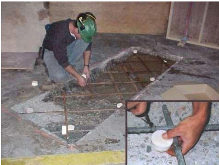
Figura 9: Instalação de anodos de proteção catódica durante os serviços de recuperação do concreto.
