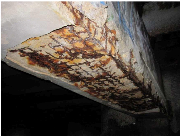
Figura 4: Corrosão em estrutura de concreto de Estação de Tratamento de Esgoto. Esses problemas somente podem ser resolvidos em definitivo com a instalação dos anodos de proteção catódica.
