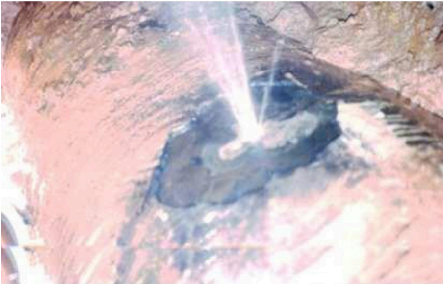
Figura 2: Furo em uma adutora enterrada causado por corrosão. Somente a instalação do sistema de proteção catódica consegue evitar que problemas como esse aconteçam.
