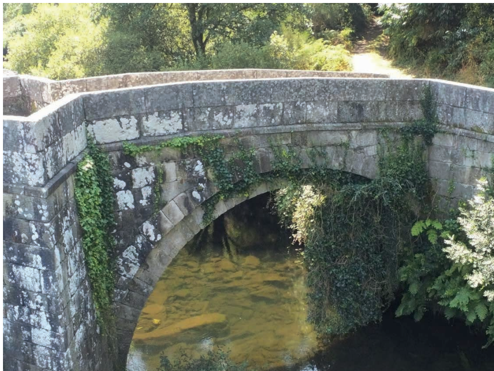
Figura 10: Vista general de unos de los arcos mayores del Puente de Brandomil, visto desde el lado aguas arriba, en imagen captada con el drone multi rotor empleado en la inspección, donde se puede observar la abundante presencia de vegetación enraizada en los múltiples elementos (fotografía del autor).
