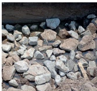
Figura 10 – Enrocamento de pedra de mão com nível d'água aflorado no fundo da vala
