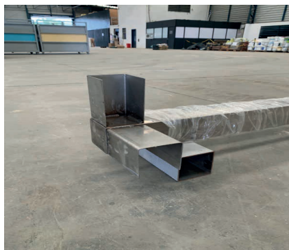
Figura 07 – Detalhe da viga inferior com perfis “U” soldados para viabilizar os encaixes
