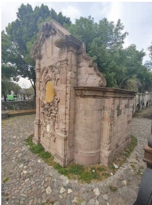
Figura 3. Acueducto de Guadalupe, bardeado en una parte y con basura por debajo. Foto propia tomada en marzo de 2022
