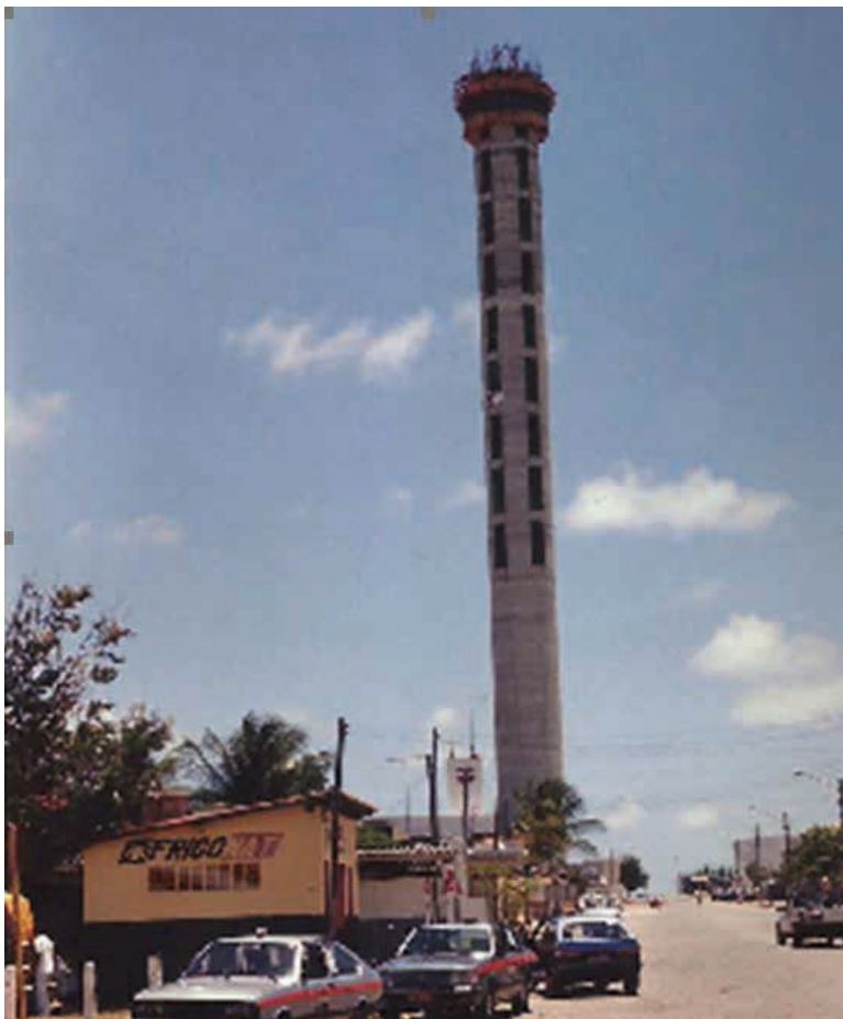
Figura 9- Construção da torre de concreto da ERB de Ponta Negra com formas deslizantes
