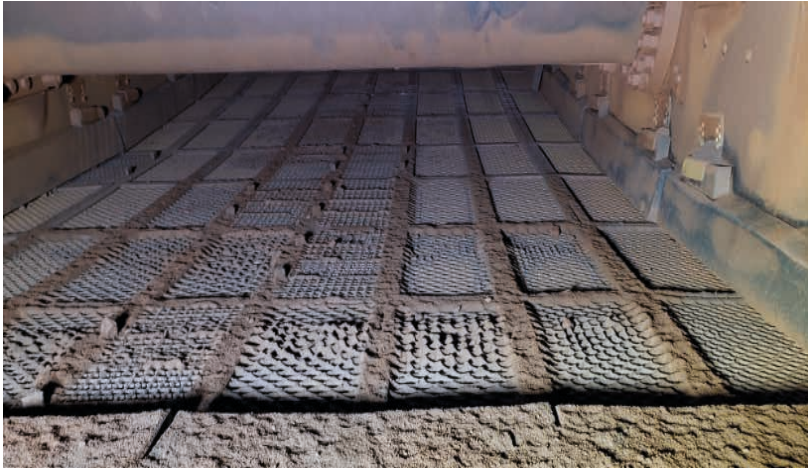
Figura 9. Início do processo de desgaste em telas de aço da linha A.
