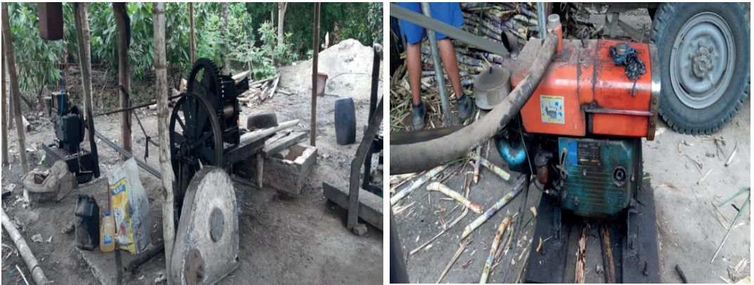
Figura 2. Generadores diésel utilizados en las pequeñas industrias.
