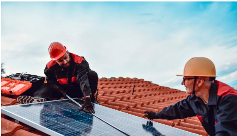
Figura – 1: Exemplo de um conjunto de painéis solares instalados em uma residência.
