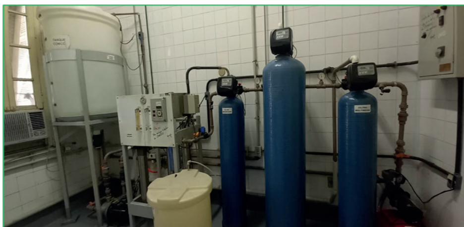
Figura 5 - Sistema de Tratamento de Água para Hemodiálise
