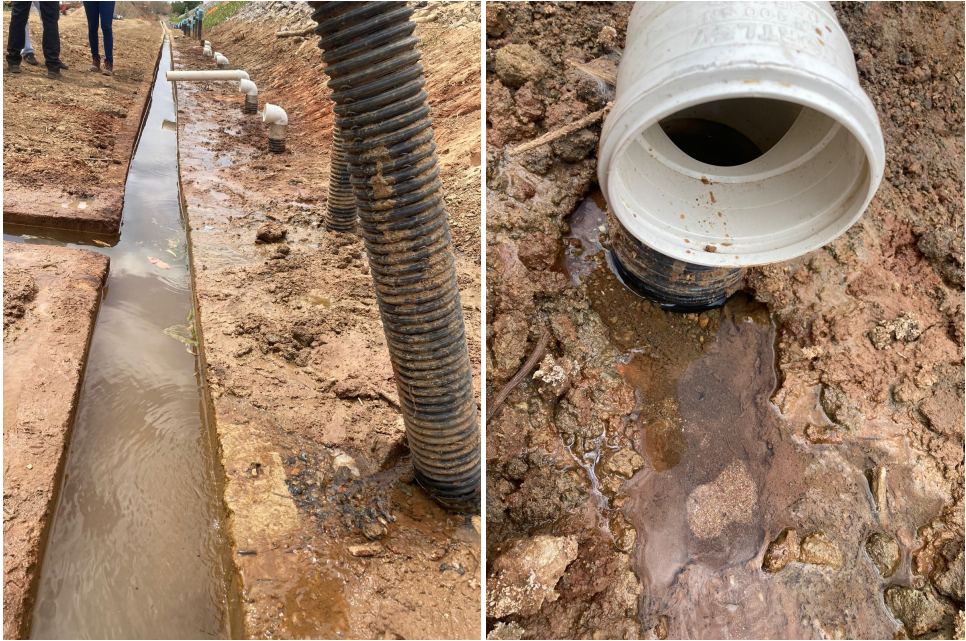
Figuras 8 e 9 - Registro dos poços de alívio da barragem auxiliar, aonde foi observado a presença de carreamento de material / surgência.
