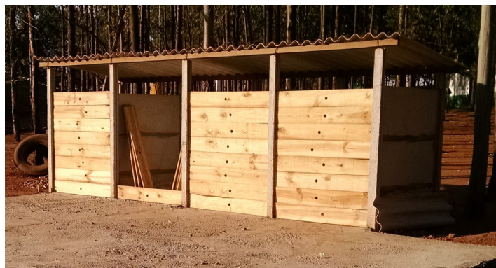
Figura 2. Composteiras e pátio de compostagem no aterro sanitário de Catalão
