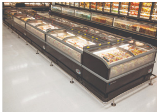
Figure 11. Self R290 Island - Eletrofrio.
