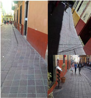
Los accesos a los diferentes establecimientos a lo largo de toda la zona de estudio se encuentran con grandes desniveles algunos más arriba otros inferior del nivel de la calle. Fuente: Elaboración propia. 2018.
