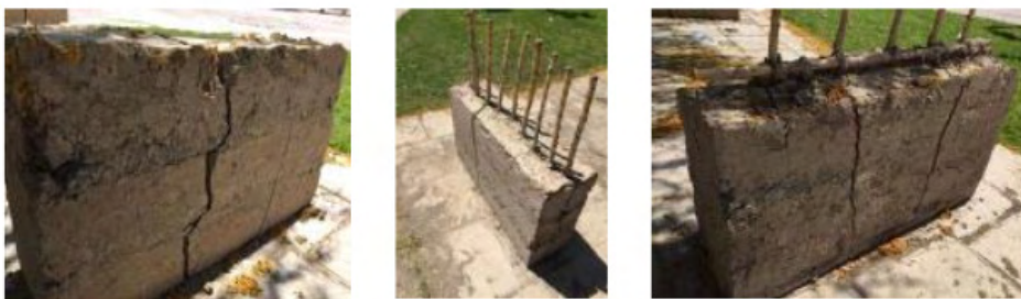
Figura 5. Agrietamiento en muros con suelo de Matamoros Coahuila.
