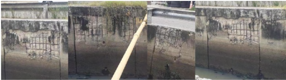
Figura 3 – Armadura exposta Fonte: Os autores (2022)
