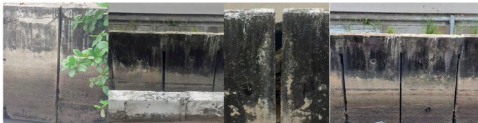
Figura 7 – Juntas sem preenchimento
