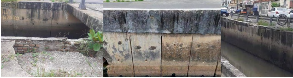
Figura 2 - Trecho do canal com parte superior quebrada
