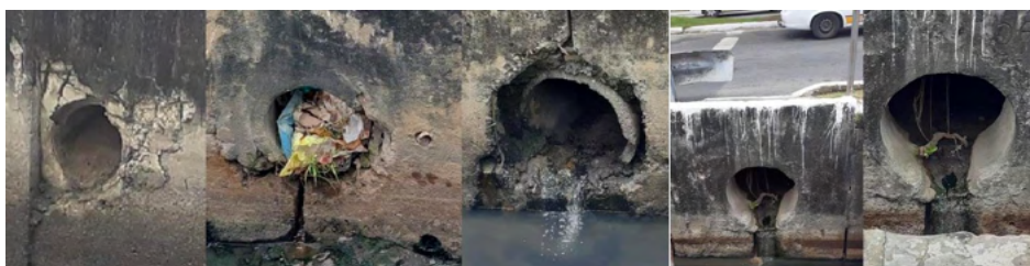
Figura 5 – Galerias pluviais quebradas e/ou entupidas.
