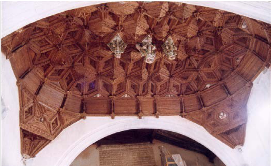
Fig. 4 Armadura de cubierta manierista (s XVI-XVII) de la Iglesia de Santa María del Río en Castroverde de Campos (Zamora).
