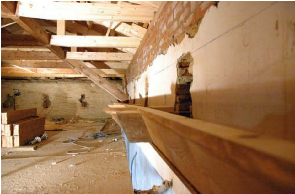
Fig. 11 Apoyo de la armadura de la nave sobre canes intestado en el muro.
