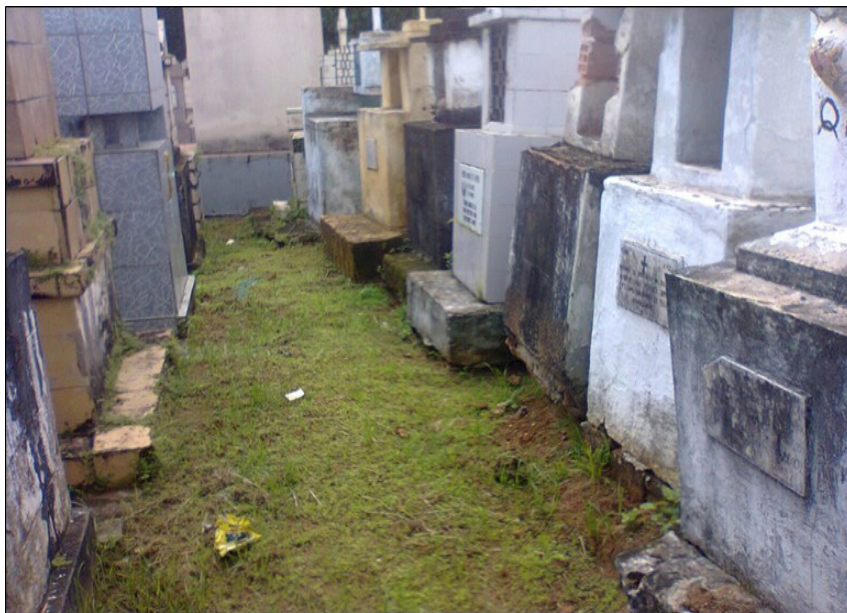
Figura 2: Condições estruturais dos jazigos no cemitério São Luís.
