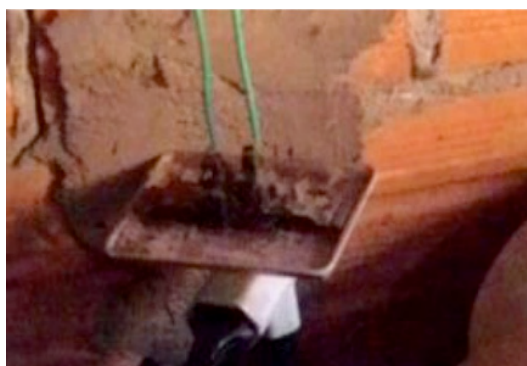
Figura 4 – Interruptor de luz não afixado
