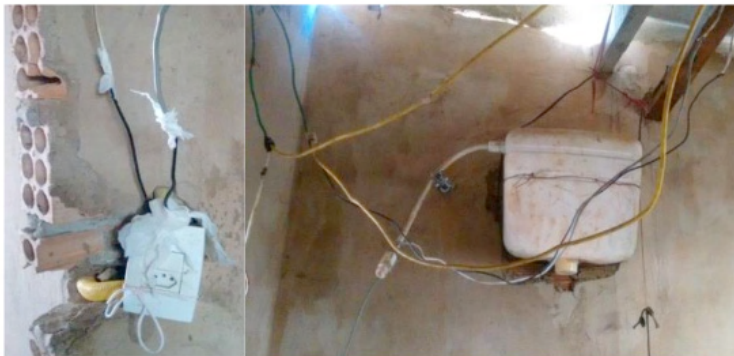
Figura 5 – Fiação exposta, alto número de emendas
