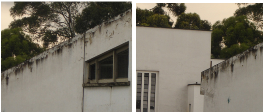
Figura 4. Deterioros en construcciones modernas, Bogotá, Colombia.
