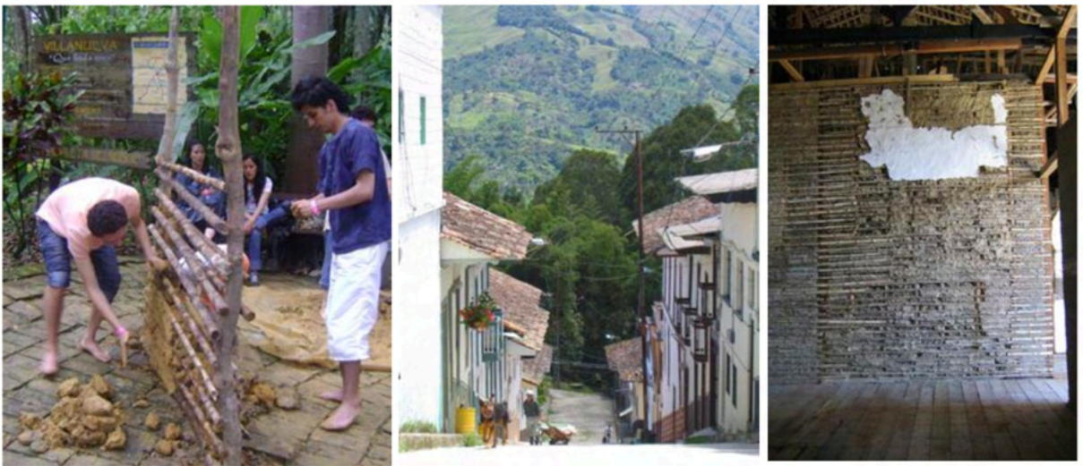
Figura 9. Construcciones en Bahareque, estudiantes de documentación construcción de muro en bahareque colonial Salamina, Colombia.
