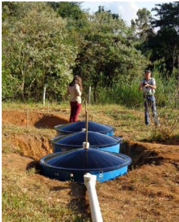
Figura 4: FSB instalada em Holambra.
