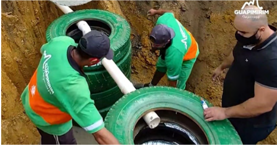
Figura 13: Fossa, filtro e sumidouro com pneus.
