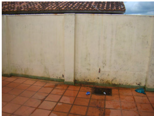
Figura 14 - Fungos e mofo junto a parede norte no pátio.
