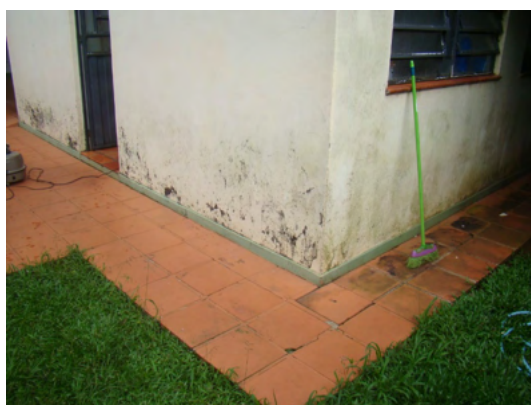
Figura 5 – Umidade ascendente parede externa lavanderia.
