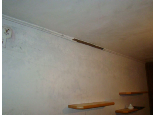
Figura 8 - Umidade generalizada parede interna sul dormitório 02.
