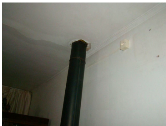
Figura 7 – Umidade na laje devido a umidade proveniente da cobertura.
