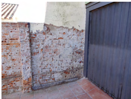
Figura 15 - Ensaio destrutivo junto a parede norte no pátio.
