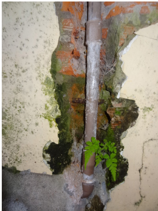
Figura 12 - Fungos e mofo junto a tubulação de entrada de água.
