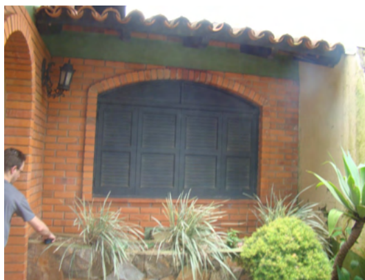
Figura 2 - Pontos de eflorescências na edificação.
