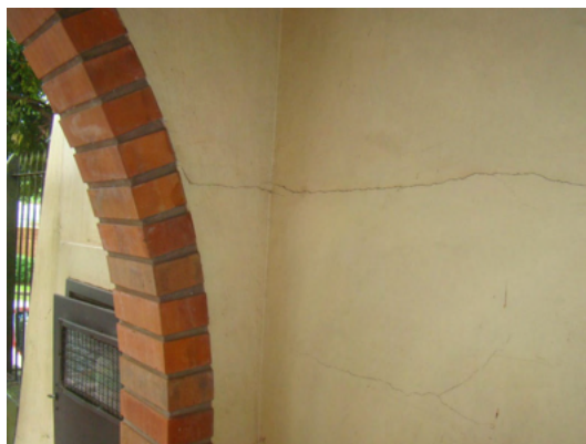
Figura 17 - Fissuras devido a infiltração de água pela algeroz do vizinho.
