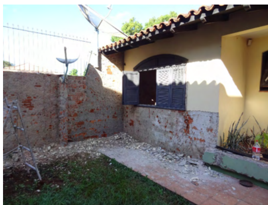
Figura 4 - Ensaio destrutivo parede externa dormitório 02.
