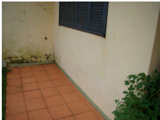
Figura 3 - Umidade ascendente parede externa dormitório 02.
