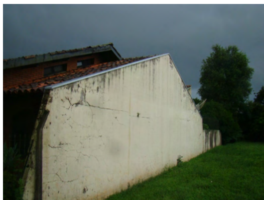
Figura 19 - Fissuras generalizadas na parede externa sul dos dormitórios 01 e 02.
