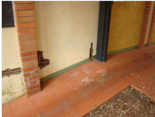
Figura 1 - Pontos de eflorescências na edificação.
