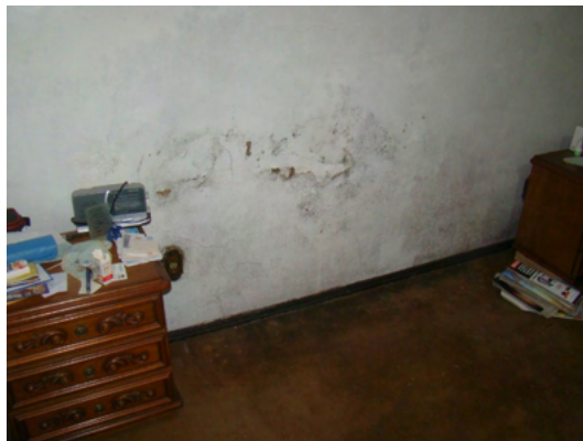
Figura 10 - Umidade generalizada parede interna sul dormitório 01.
