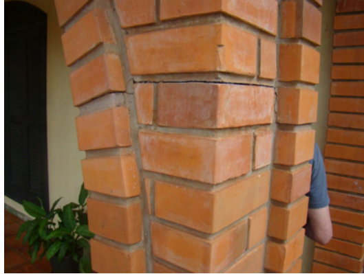
Figura 16 – Fissuras nos pilares de alvenaria sem armadura.
