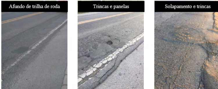
Figura 17 – Registros de patologias na camada asfáltica da Avenida Alberto Diniz.
