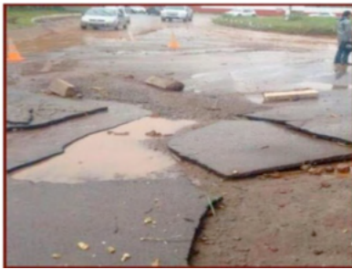
Figura 5 - Asfalto Danificado após a Chuva/ Rotatória Rua Rachid Neder
