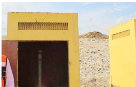
Imagen 7. Vista General de los Quemadores.
