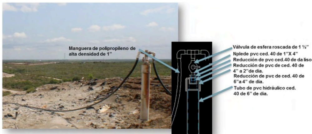
Imagen 4. Colocación de los puntos de respiración y conexión de las mangueras para dirigir el biogás.
