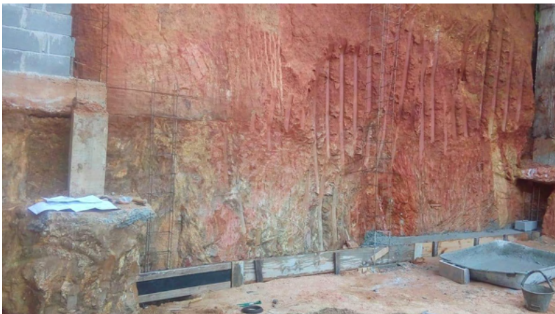
Figura 6 - Talude de corte (Acervo Fotográfico do Autor)..
