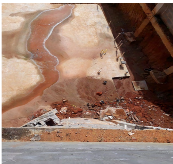
Figura 9 - Novo evento de ruptura (Acervo Fotográfico do Autor)..
