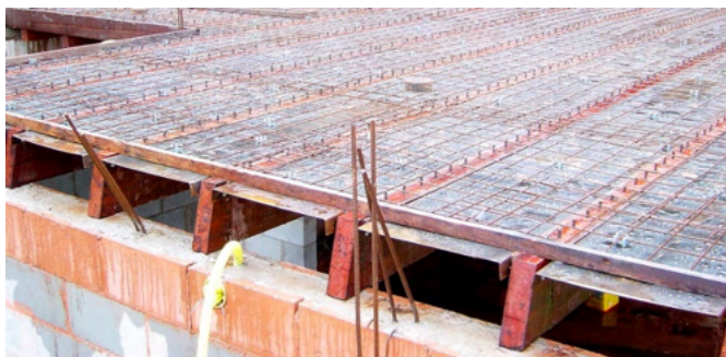
Figura 7 - Estrutura mista de laje de concreto moldada in loco nas vigas de madeira, apoiadas no muro de alvenaria.
