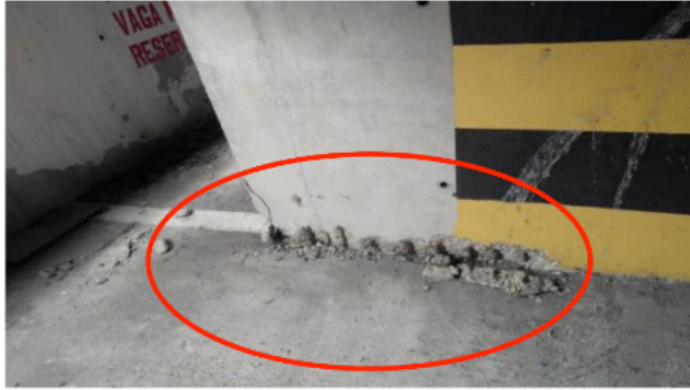
Figura 1. Corrosão da armadura na base do pilar.
