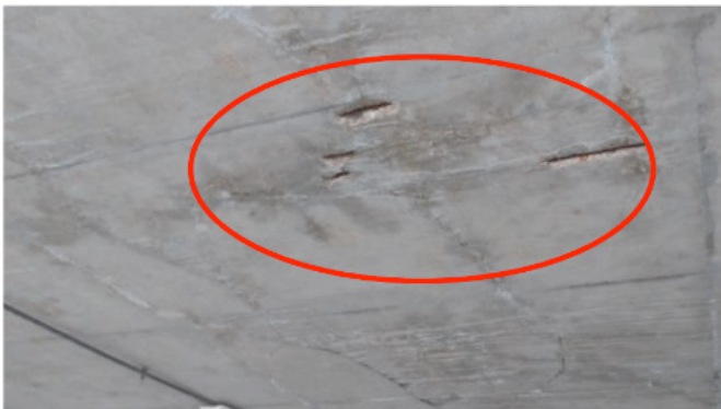
Figura 2. Carbonatação do concreto.
