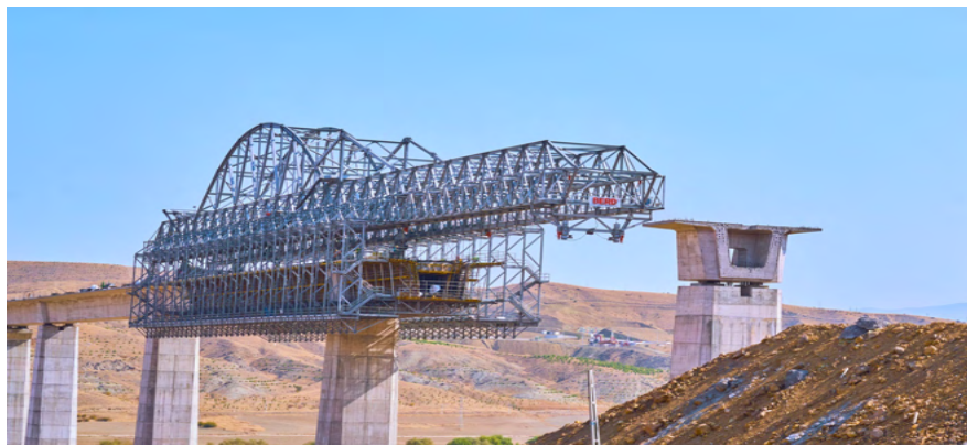
Figura 12. Imagen del M1-90-S en fase operación.
