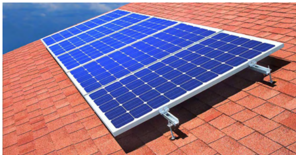
Figura. 1 Exemplo de um conjunto de painéis solares instalados em uma residência.
