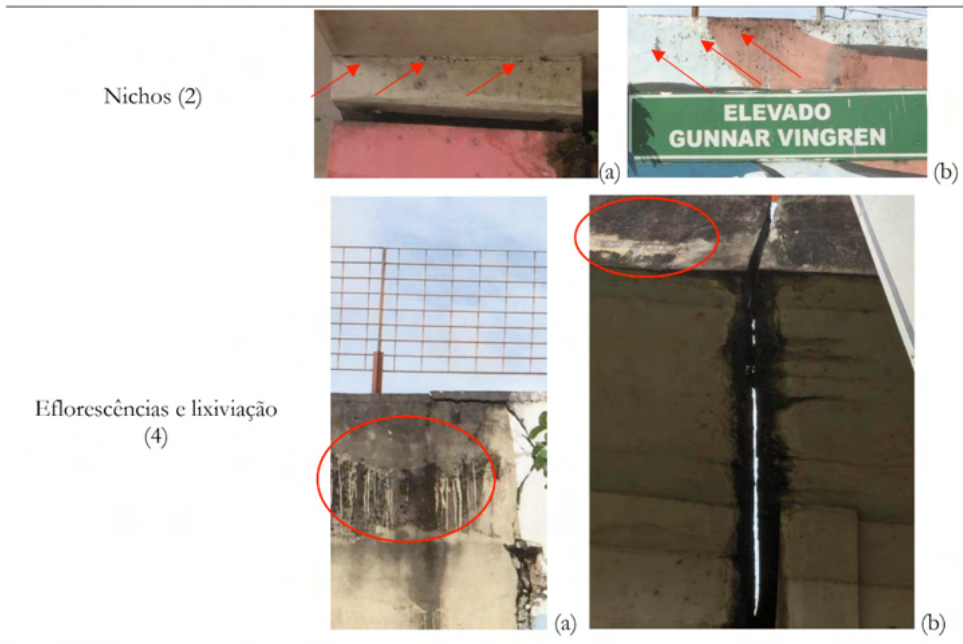
Quadro 1. Registro das manifestações patológicas identificadas no Elevado “Gunnar Vingren”.
