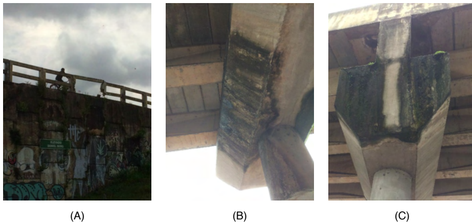
Figura 5. Anomalias. (A) Ação mecânica; (B) Infiltração e corrosão; (C) Manchas Escuras.
