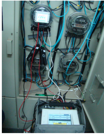
Figura 20. Medidor de energia em avaliação.
