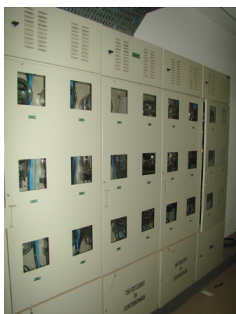
Figura 19. Painel de condomínio com vários medidores.
