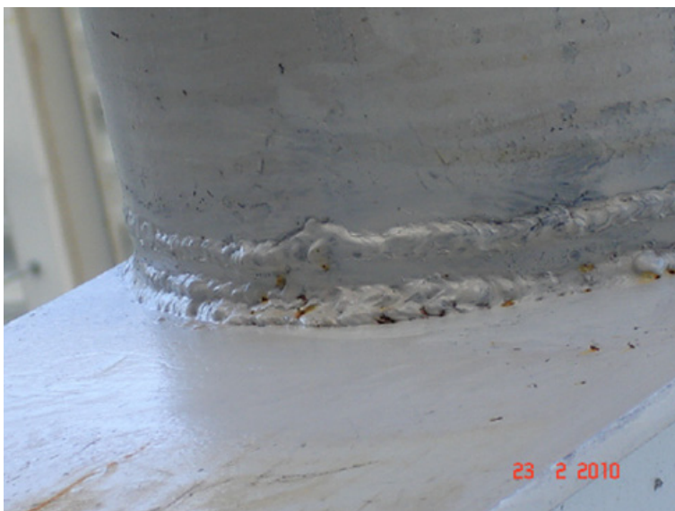
Figura 29 – Exemplo de mordedura combinada com desalinhamento do cordão de solda.
