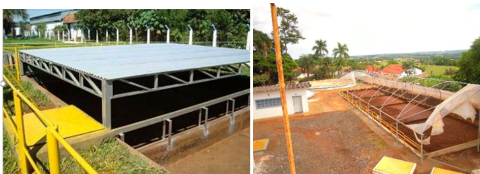
Figura 12 – Leito de drenagem com cobertura na ETA de Cardoso/SP e Monte Aprazível/SP.
