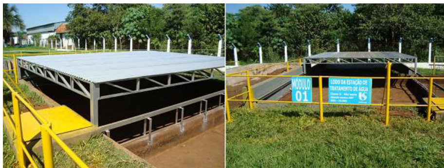
Figura13 - Cobertura móvel instalada no LD da ETA de Cardoso-SP.
