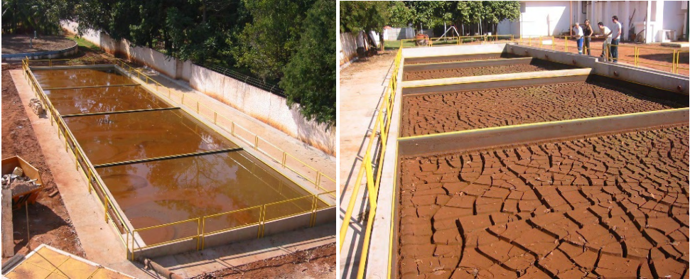
Figura 16 - Leito de Drenagem em escala real na ETA de Monte Aprazível – SP.
