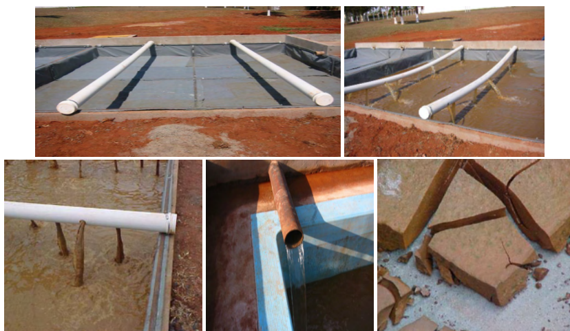
Figura 14 - Leito de Drenagem em escala real na ETA de Cardoso – SP.
