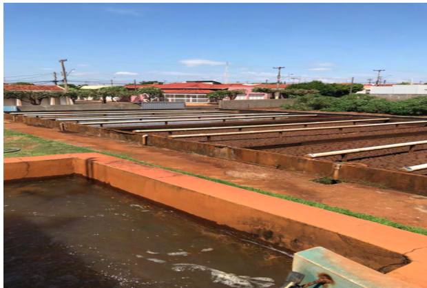
Figura 17 - Leito de Drenagem em escala real na ETA de Viradouro – SP.
