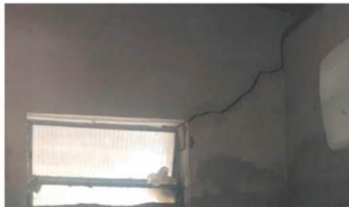
Figura 4 – Fissuras banheiro masculino
