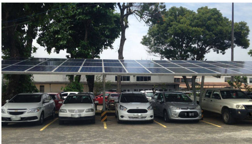
Figura 1 – Painéis instalados no estacionamento ( carport ).
