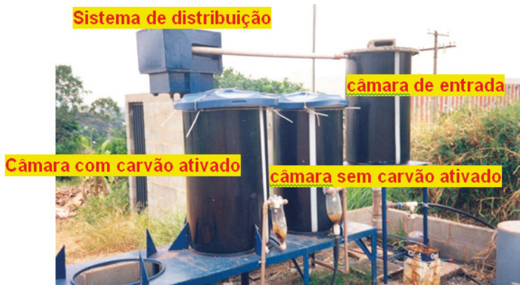
Figura 5: Detalhe do conjunto de filtro lento.
