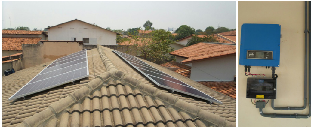
a) Módulos fotovoltaicos
