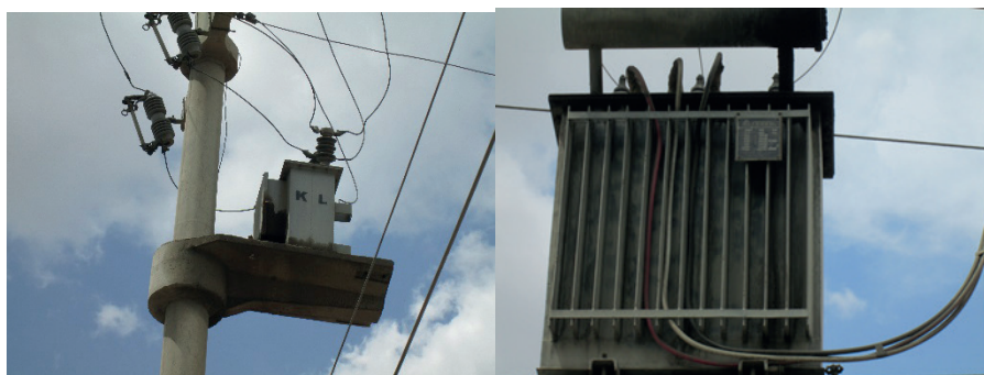
Foto 1: Se aprecia la contaminación del aceite mineral en el transformador
