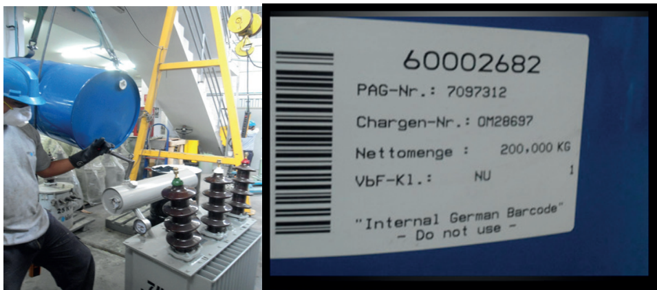
Foto 2: Se aprecia cambio de silicona líquida a los transformadores
